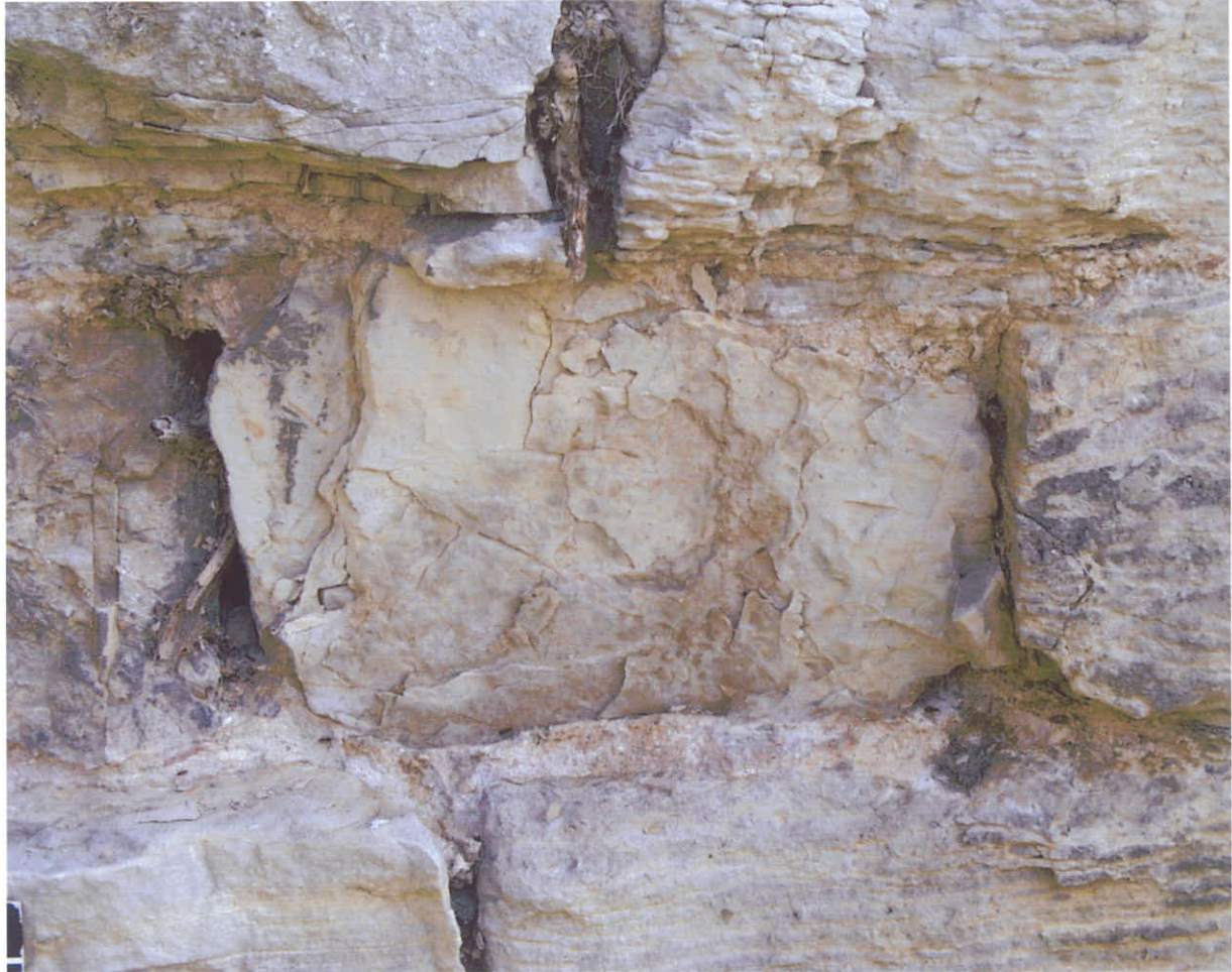
Bild 17: Schalenbildung an einem Stein des Sichtmauerwerks, der gegen das Lager (Schichtung senkrecht) verbaut wurde. Die Verwitterungstiefe beträgt bereits mehrere Zentimeter.
