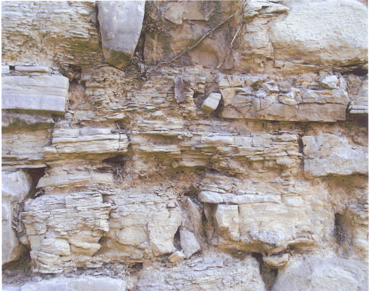
Bild 14: Durch Rissbildung und Aufschieferung zerstörte Steine des Sichtmauerwerks
