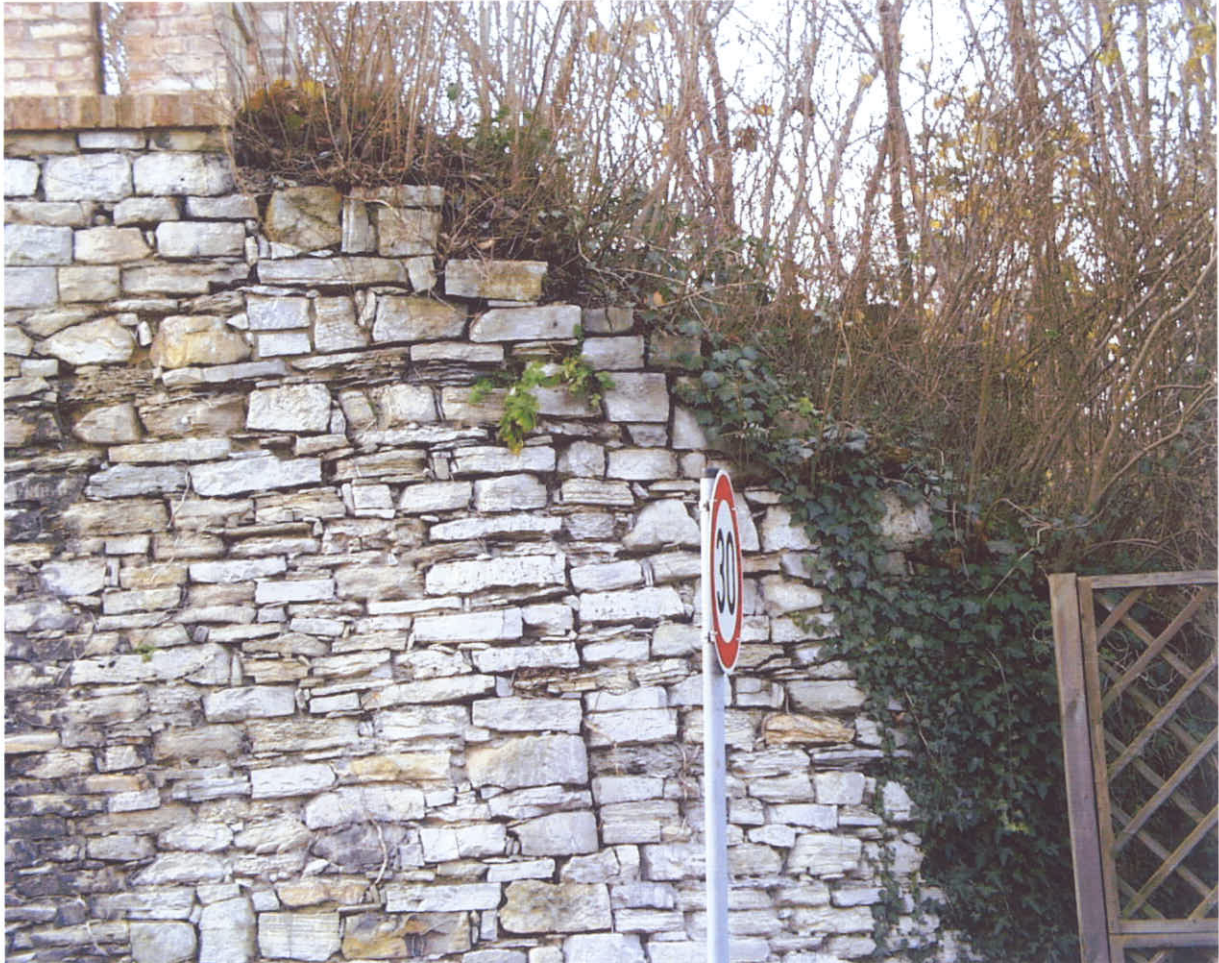
Bild 3: Baufuge am Nordöstlichen Abschluss der Stützwand im Anschluss an das ehemalige "Schweitzerhaus".
