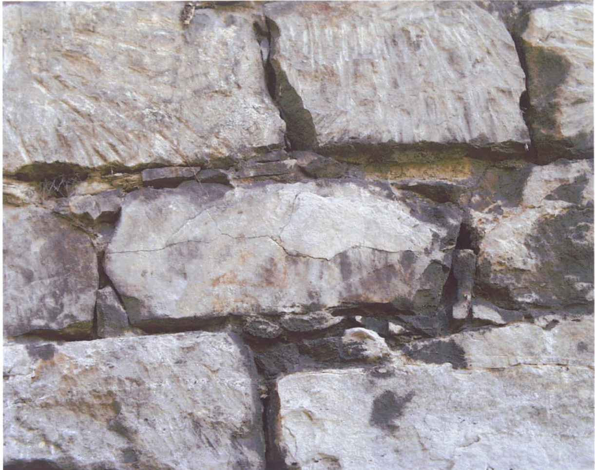
Bild 12: Schadensbild Rissbildung im Stein des Sichtmauerwerks Der Stein wurde mit dem Lager verbaut (Schichtung wagerecht).
