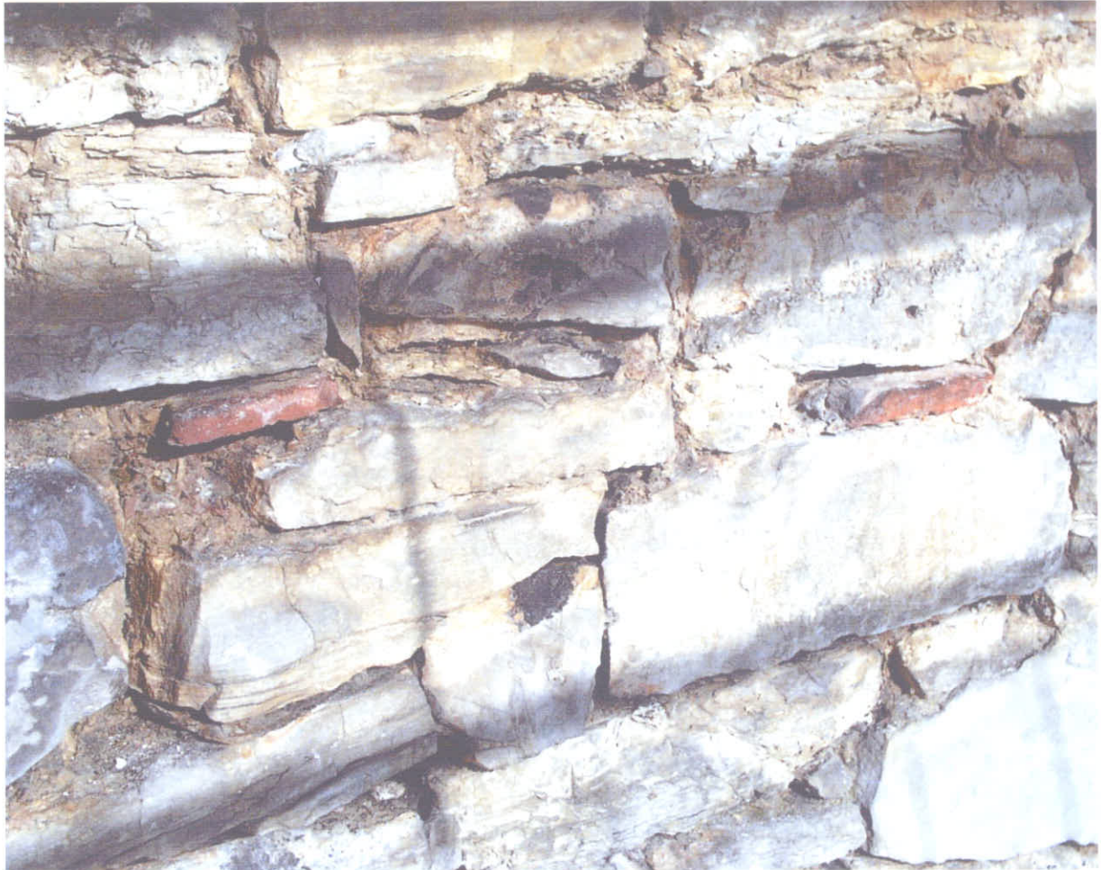
Bild 11: Auswickelungen der Fugen mit Ziegelstücken im Bereich zwischen Achse 11 und 12
