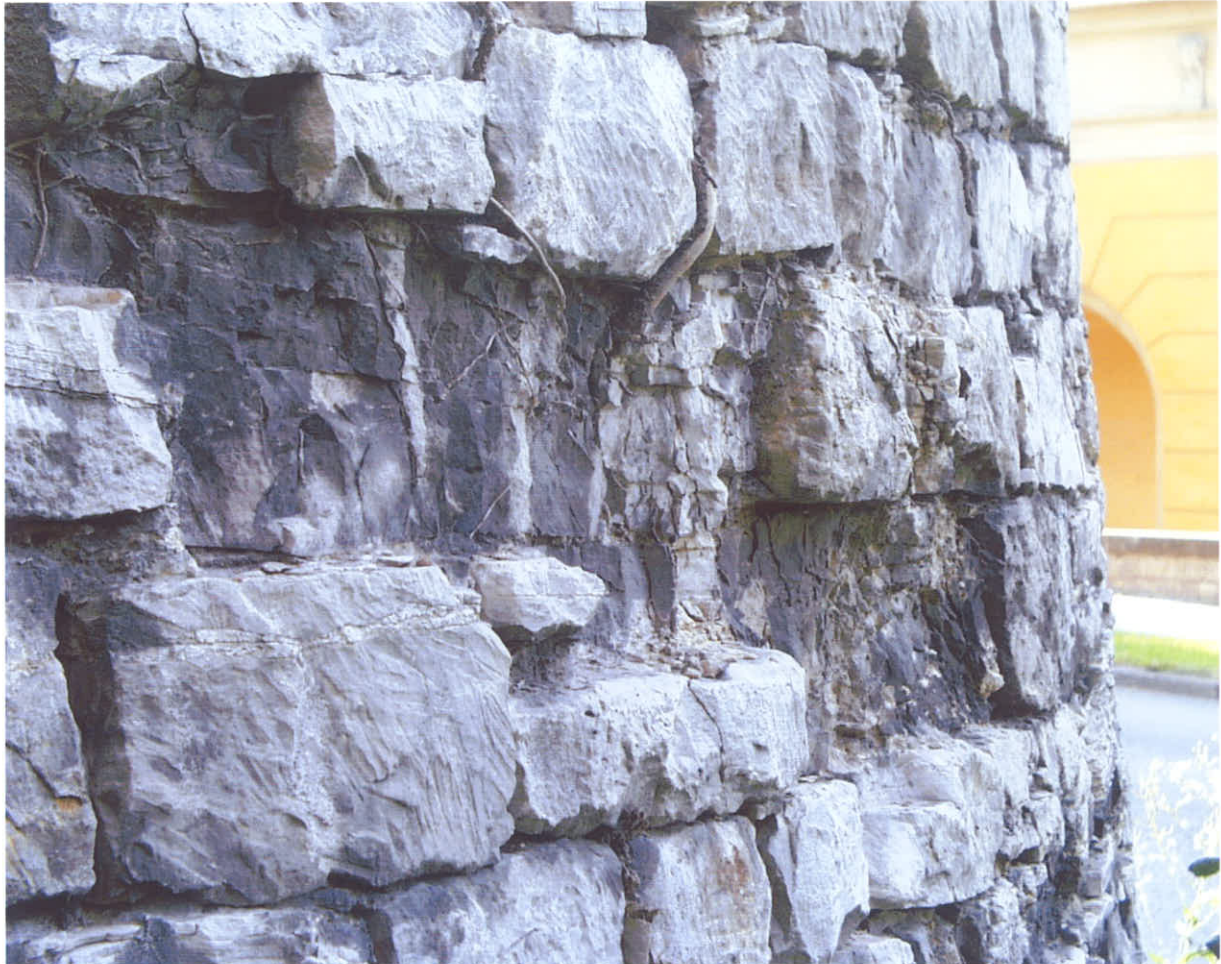
Bild 19: Substanzverluste an Steinen des Sichtmauerwerks im Abschnitt zwischen Achse 2 und 3, die mit dem Lager (Schichtung wagerecht) verbaut wurden, jedoch stark zerrissen und zerklüftet sind. Die Verwitterungstiefe beträgt bereits mehrere Zentimeter.
