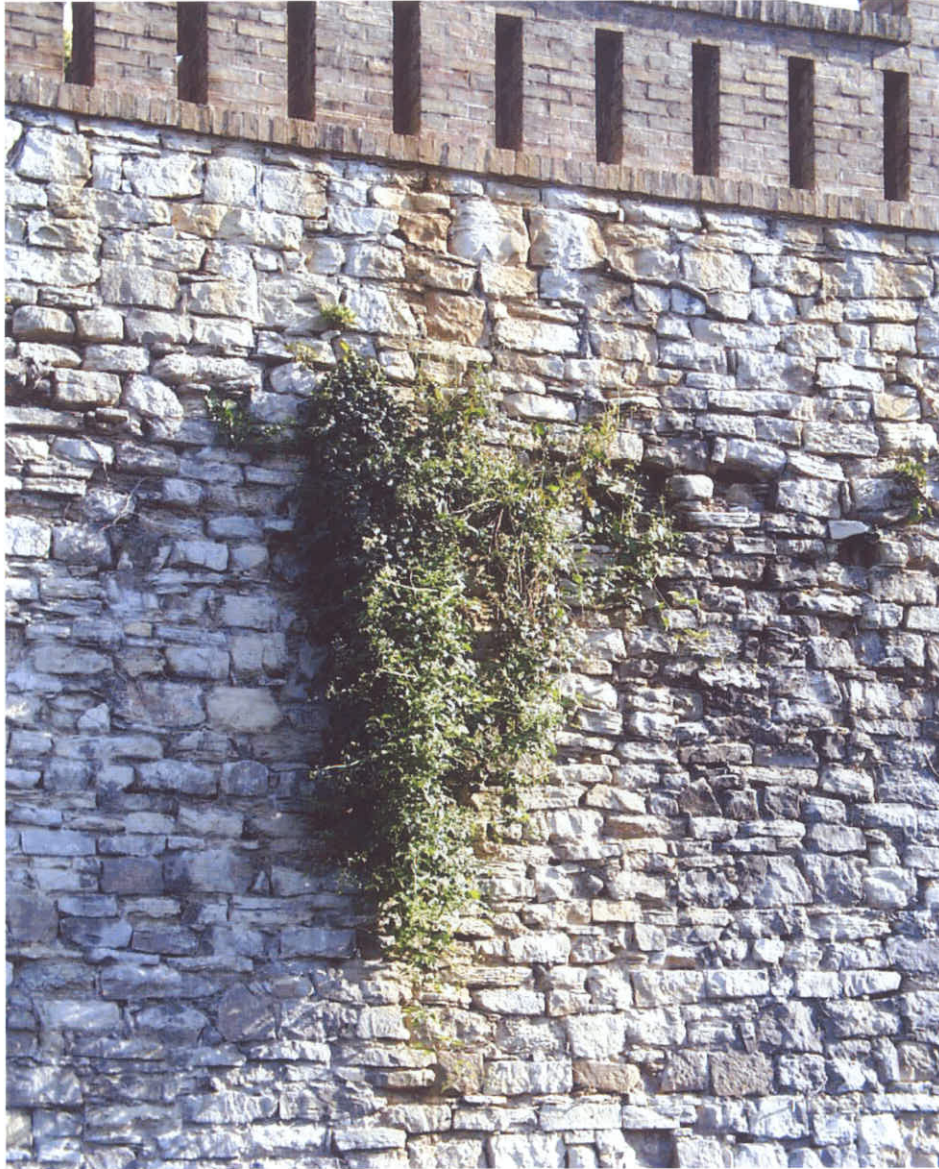
Bild 25: Wurzelstock im Mauerwerk mit Austrieb (Abschnitt zwischen Achse 11 und 12)
