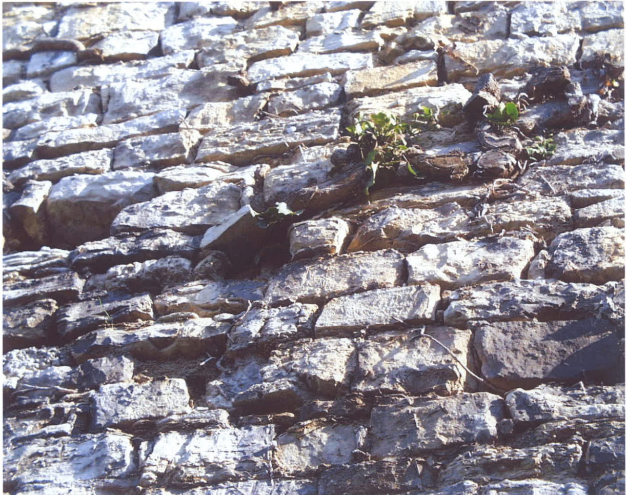
Bild 26: Wurzelstock im Mauerwerk (Abschnitt zwischen Achse 12 und 13)
