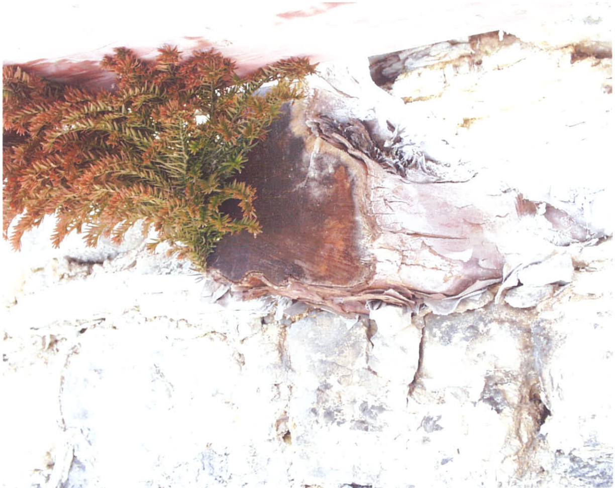
Bild 23: Durchwurzlung des Mauerwerks mit Austrieb (Abschnitt zwischen Achse 10 und 11)
