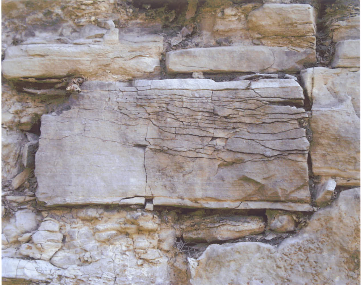
Bild 13: Schadensbild Rissbildung / Zerklüftung / Aufschieferung Der Stein wurde mit dem Lager verbaut (Schichtung wagerecht).
