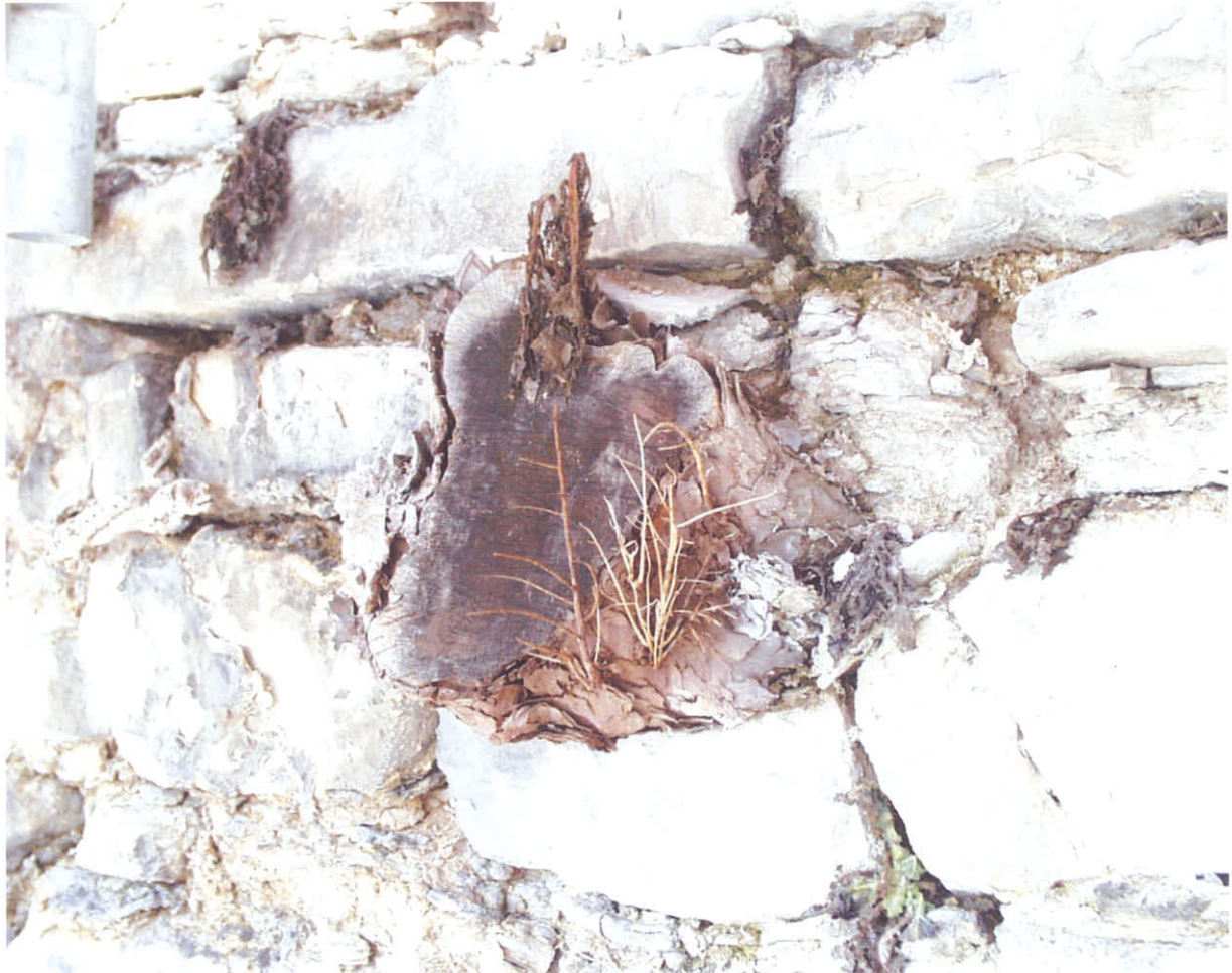
Bild 24: Durchwurzlung des Mauerwerks (Abschnitt zwischen Achse 11 und 12)
