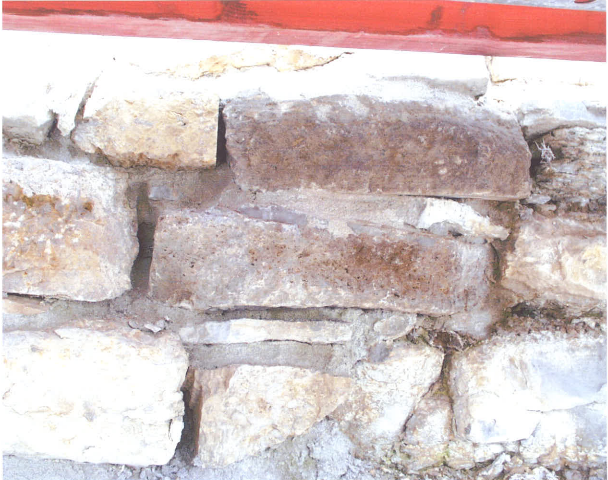
Bild 8: Ausgebesserter Bereich zwischen Achse 09 und 10 Für die Ausbesserungen wurden Fränkische Kalksteine und Kalkstein aus dem Altmühltal (Bayern) verwendet. Die Fugen sind mit zementhaltigem Mörtel geschlossen.
