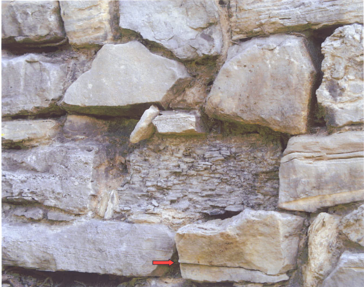
Bild 15: Durch Rissbildung und Aufschieferung zerstörter Stein des Sichtmauerwerks, ➡ darunter Stein mit einfacher Rissbildung
