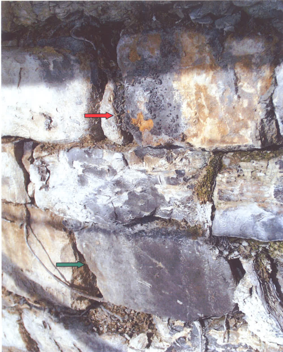
Bild 21: Krustenbildungen auf den Oberflächen der Kalksteine des Sichtmauerwerks im Abschnitt zwischen Achse 13 und 14
