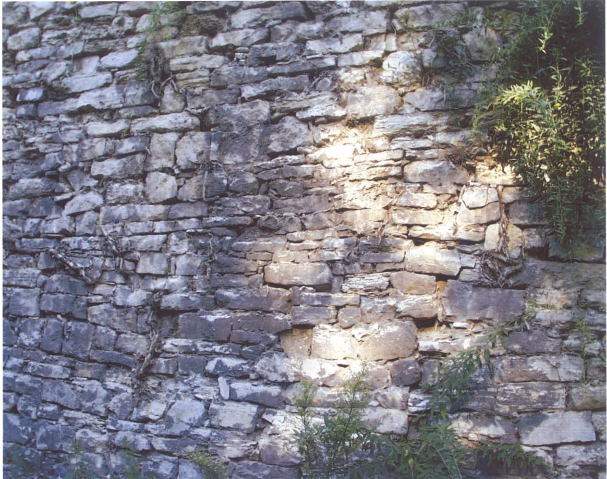
Bild 20: Krustenbildungen auf den Oberflächen der Kalksteine des Sichtmauerwerks im Abschnitt zwischen Achse 19 und 20
