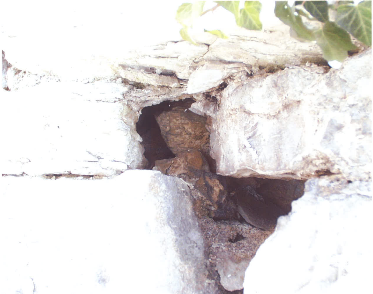
Bild 22: Hohlräume im Mauerwerk (Abschnitt zwischen Achse 4 und 5)
