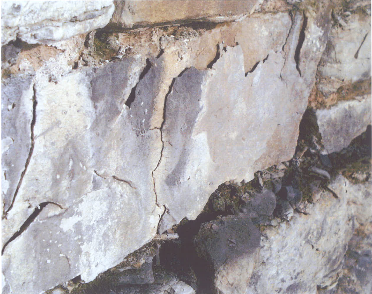
Bild 18: Starke Schalenbildung an einem Stein des Sichtmauerwerks, der gegen das Lager (Schichtung senkrecht) verbaut wurde. Die Verwitterungstiefe beträgt bereits mehrere Zentimeter.
