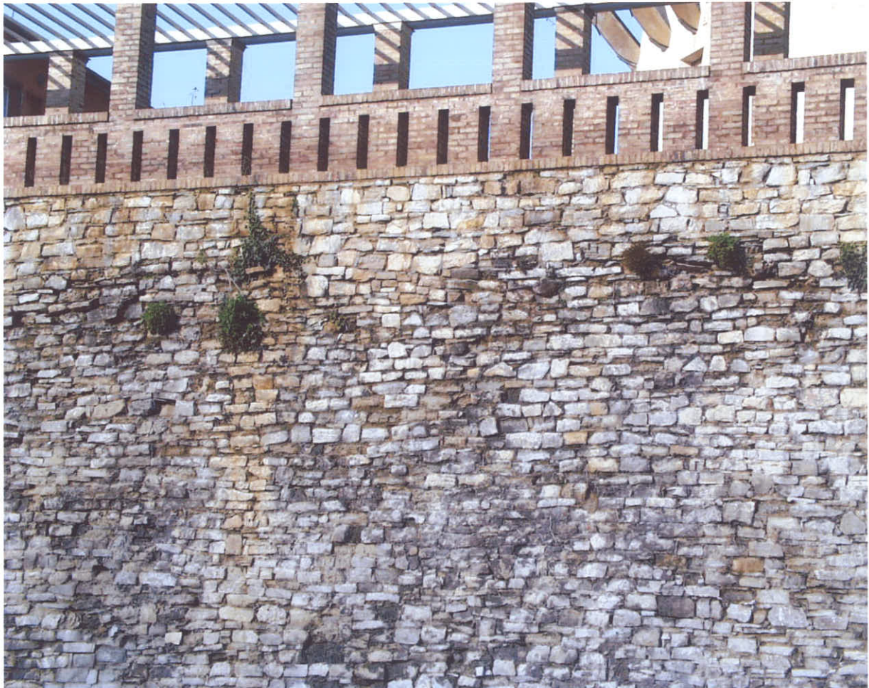
Bild 2: Abschnitt zwischen Achse 08 und 12 Im Grenzbereich zwischen dem großformatigen und regelmäßig geschichtete Mauerwerk der Mauerkrone unterhalb der Pergola und dem darunter liegenden Mauerwerk ist die Stützwand annähernd in einer Ebene von starken Wurzelstöcken durchwachsen.
